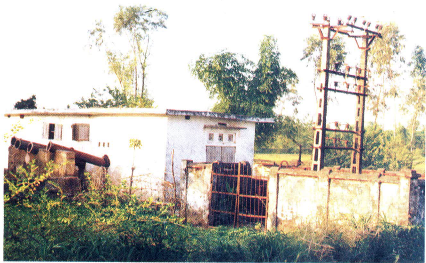
Trạm bơm Hàm Long Nguyễn Ủy
